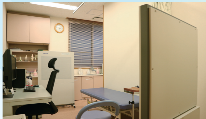
クリーン仕様(清浄空気吹き出し型)と汚染除去仕様(吸引集塵型)のHEPAフィルター付きクリーンパーティションを設置した診察室
